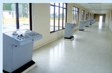
Sala de comandos de filtros
